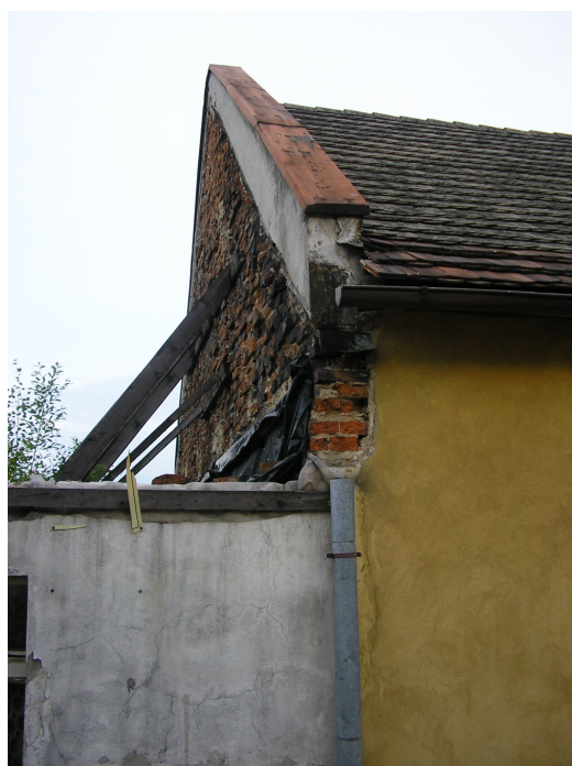
Rysunek 2 Drewniane przypory zabezpieczające ścianę szczytową wspólną dla budynków numer 33 i 35
