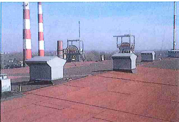
Fot. 3. Tłumiki na wydmuchach na dachu budynku płuczki
