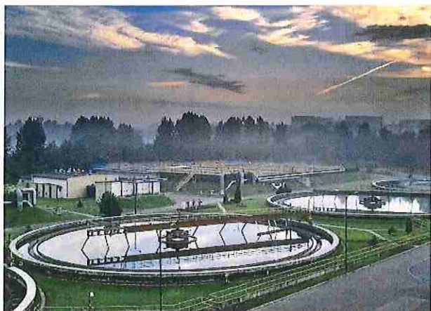
Fot. 9. OŚ Śródmieście w Zabrze, osadniki wtórne, w tle reaktor biologiczny oraz budynek stacji dmuchaw
