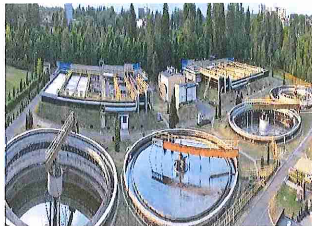
Fot. 10. OŚ Śródmieście w Zabrze osadnik wstępny, 3 osadniki wtórne, w tle 2 reaktory biologiczne oraz budynek stacji dmuchaw
