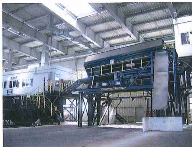
Fot. 2. Instalacja do sortowania odpadów komunalnych
