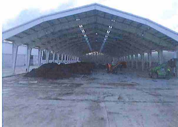
Fot. 4. Część biologiczna instalacji MBP do przetwarzania odpadów komunalnych eksploatowana przez MPKG Sp. z o. o. w Katowicach
