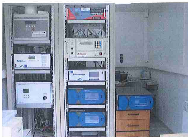
Fot. 6. Wnętrze stacji automatycznej monitoringu jakości powietrza
